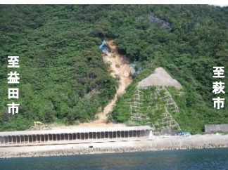
【写真③】H23年土砂崩壊の状況
