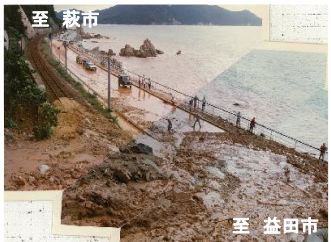
【写真②】S55年土砂崩壊の状況
