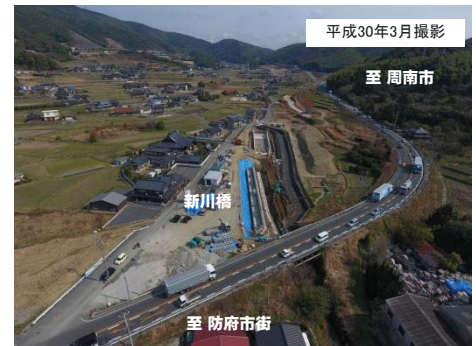
写真② 現在の橋梁工事進捗状況 (防府市街方面から周南市方面を望む)
