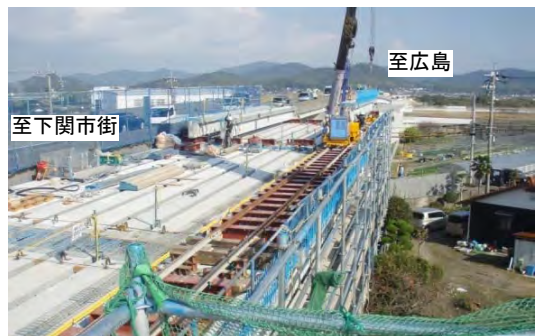
【写真②】木屋川大橋第2高架橋施工状況 (橋を架けています)
