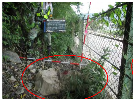
既存防護柵背面の土砂堆積状況
