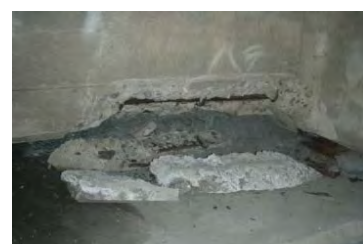
【損傷状況】コンクリート落下
