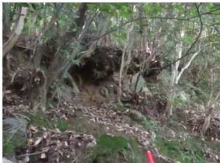
崩落斜面状況
