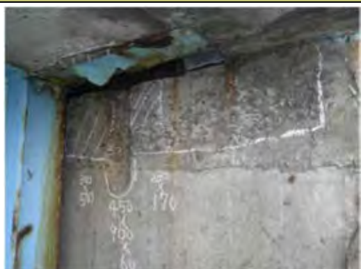
損傷状況(橋台基礎コンクリートの剥離・鉄筋露出)
