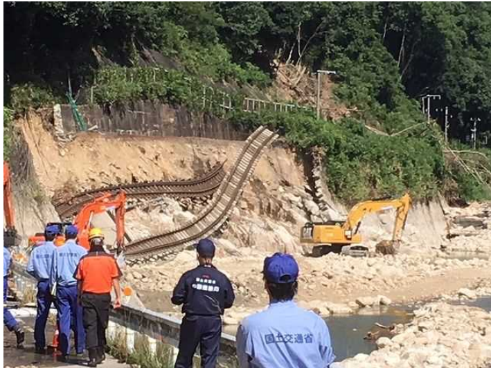
JR山陽線 河内～本郷間 被災地
