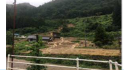
E2A 中国道(新見IC~北房IC)【法面崩落】
