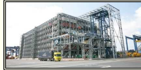
立体式コンテナ蔵置装置 (東京港 大井埠頭)
