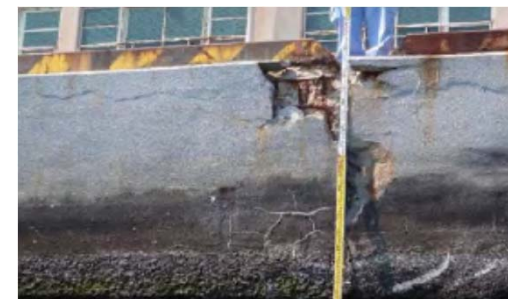
岸壁の老朽化
