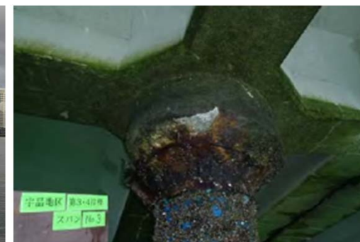
岸壁の老朽化 (栈橋式岸壁鋼管腐食)
