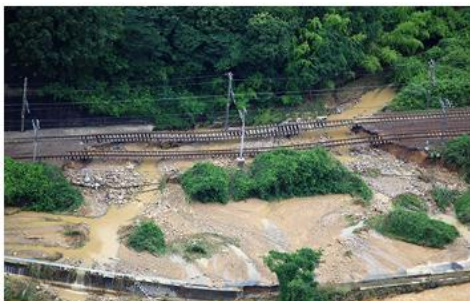
八本松～津野駅間 土砂・バラスト流出
