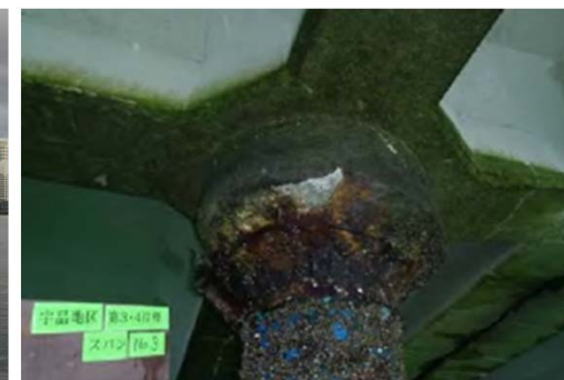
岸壁の老朽化 (栈橋式岸壁鋼管腐食)
