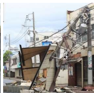
<飛来物による電柱倒壊の事例>
