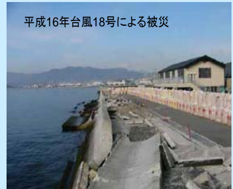
写真-1 被災状況
